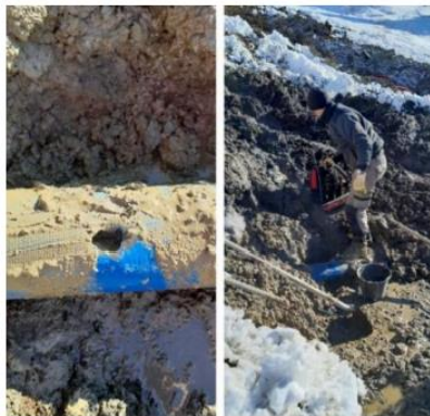
Fuite adduction 1000m3
