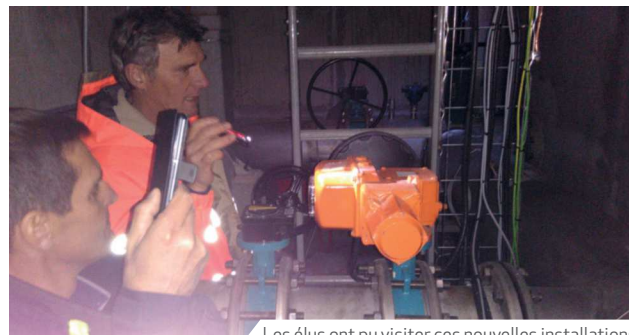
Les élus ont pu visiter ces nouvelles installations
